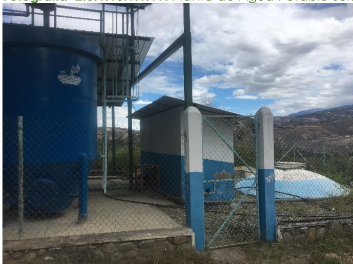
Fotografía 2.6.1.10.1.19: Planta de Agua Potable Sulupali Chico
