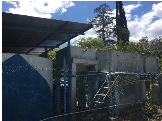
Fotografía 2.6.1.10.1.1.6: Planta de tratamiento y distribución Portovelo Grande
