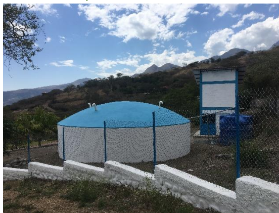
Fotografía 2.6.1.10.1.17: Planta de tratamiento y distribución San Antonio
