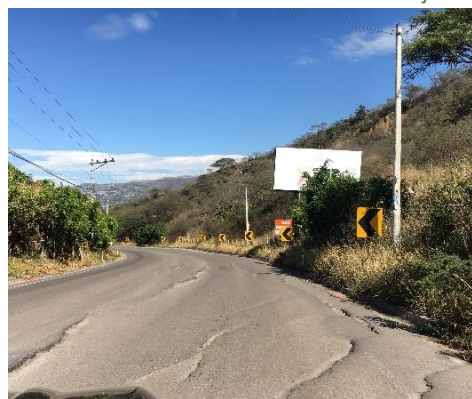
Fotografía 2.3.8.2: Falla en la calzada de la vía Cuenca-Girón-Pasaje
