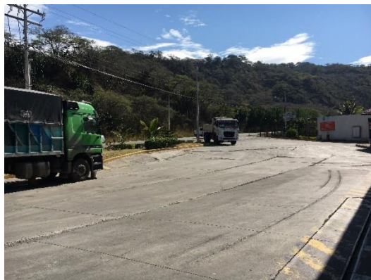
Fotografía 2.3.8.3: Falla en la calzada en la Estación de servicio
