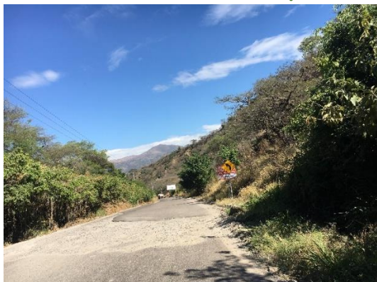
Fotografía 2.3.8.1: Falla en la calzada de la vía Cuenca-Girón-Pasaje
