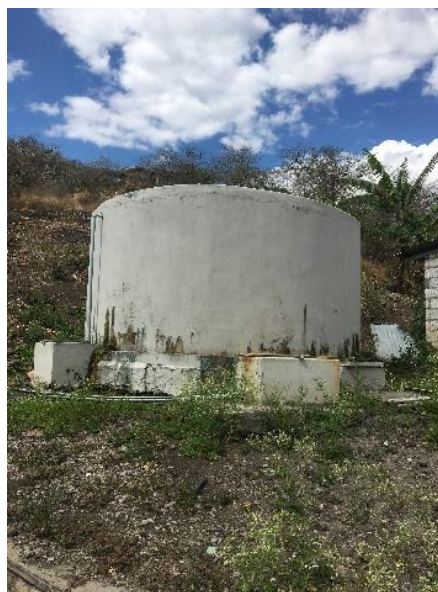
Fotografía 2.6.1.10.1.13: Tanque de Distribución de Corasari
