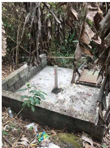
Fotografía 2.6.1.10.1.1.10: Tanque de Almacenamiento de Corasari
